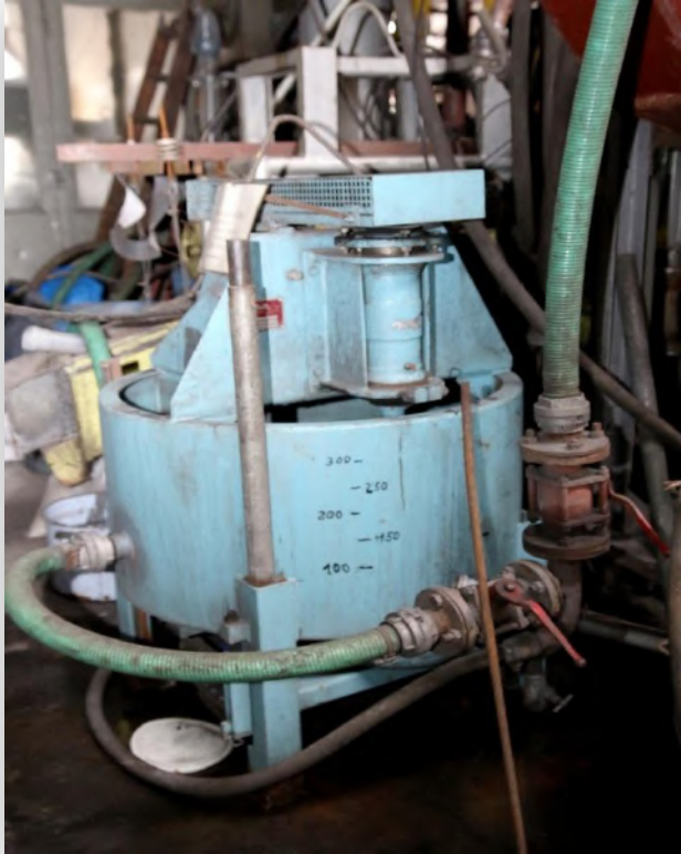
Pompa SALA ze zbiornikiem, w którym przygotowuje się odpowiednie zagęszczenie nadawy na pierwszy stopień klasyfikacji w hydrocyklonie.
